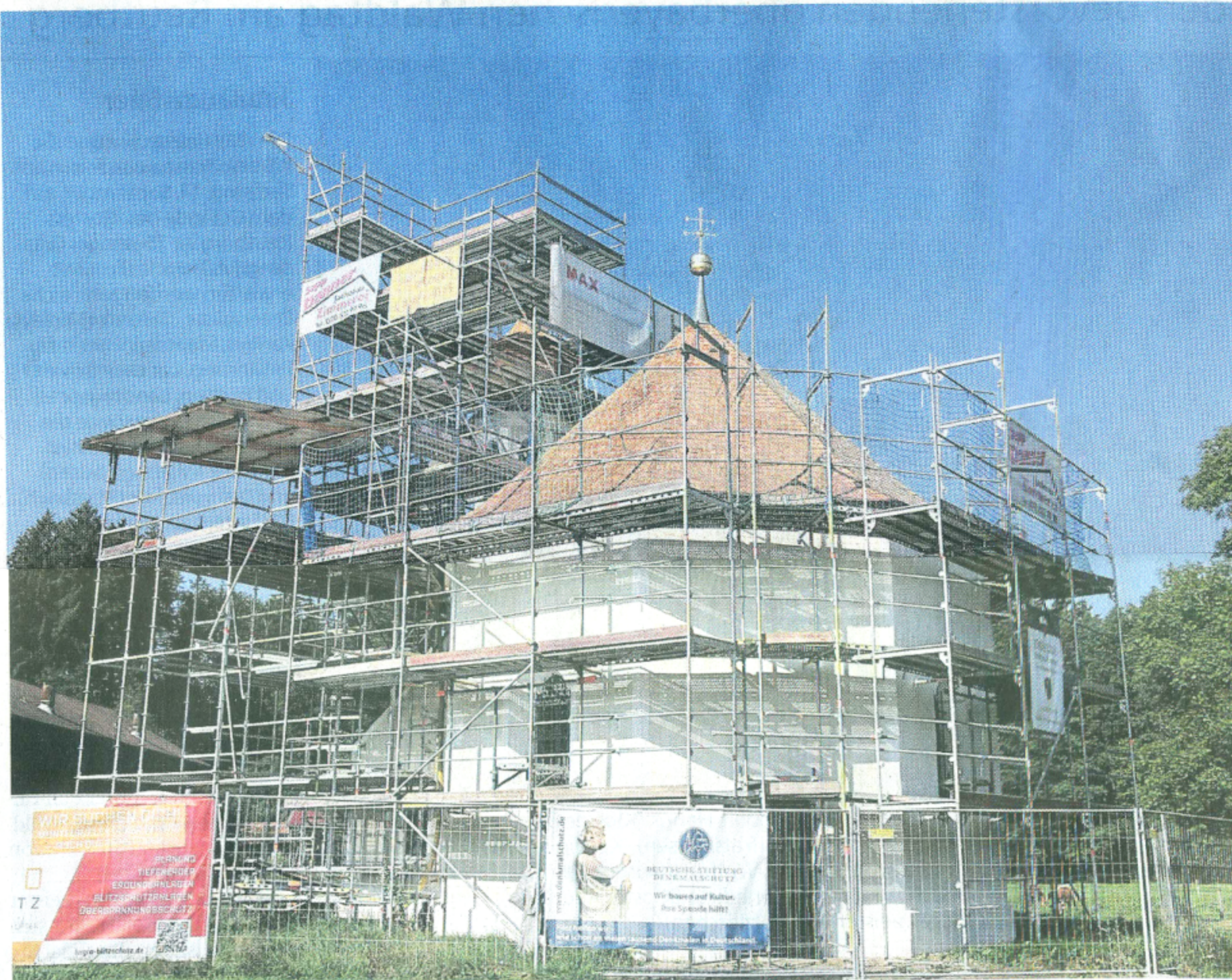
Gut versteckt hinter dem Baugerüst ist die St. Nikolauskapelle. Die Renovierungsarbeiten sind in vollem Gange.
