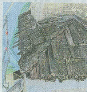
Marode Dachschindeln am Glockenturm.
